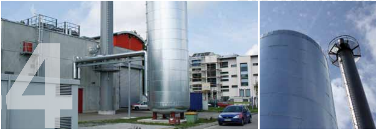
Modernes Kraftpaket: Mit 1.100 kW elektrischer und 850 kW thermischer Leistung versorgt das BHKW Vauban 2.300 Haushalte mit Wärme und Strom.
