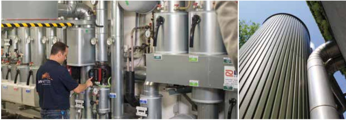
Modernes Kraftpaket: Mit 1,83 MW elektrischer und 19,305 MW thermischer Leistung versorgt das BHKW Landwasser rund 3.000 Haushalte mit Wärme und Strom.
